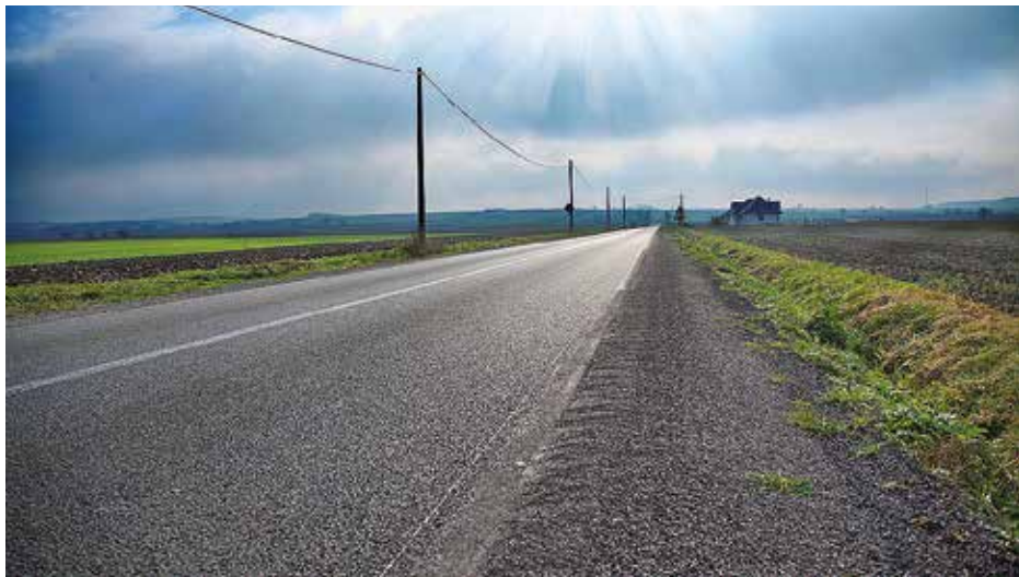
Wyremontowana droga powiatowa z Wilkowej do Łubnic. Podobną nawierzchnię posiada około 445 km, co stanowi 92% stanu posiadanych dróg powiatowych.
