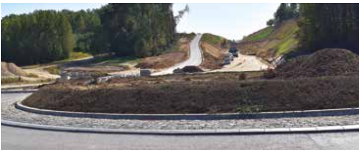
Trwają wykopy we wznesieniu przy ul. Oględowskiej, z lewej droga serwisowa z pierwszą warstwą asfaltu.
