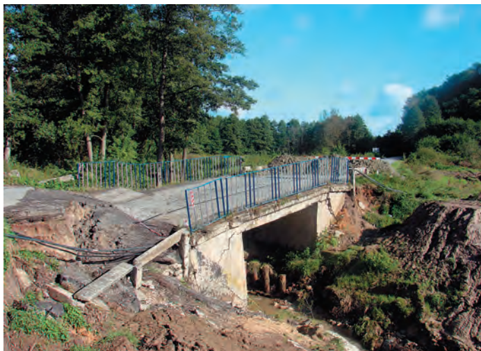
Uszkodzony most na rzece Korzennej w gminie w Bogorii, niedaleko „Buczyny”.
