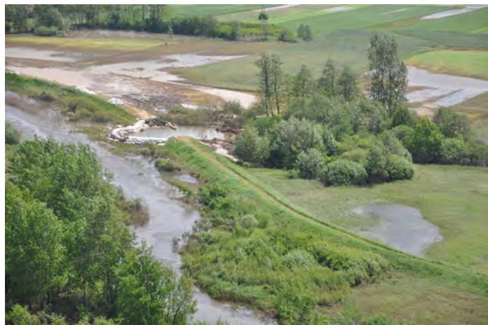
Uszkodzony wał Kanału Strumień w Rejterówce.
