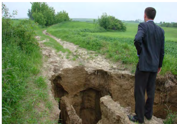
Uszkodzenie drogi Szczeglice - Moszyny obserwuje dyr. ZDP Rafał Suska.
