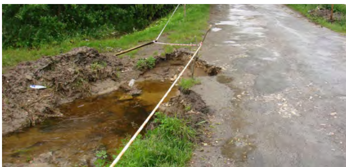
Uszkodzona droga nr 0816T Strużki - Podwale, w m. Podwale.
