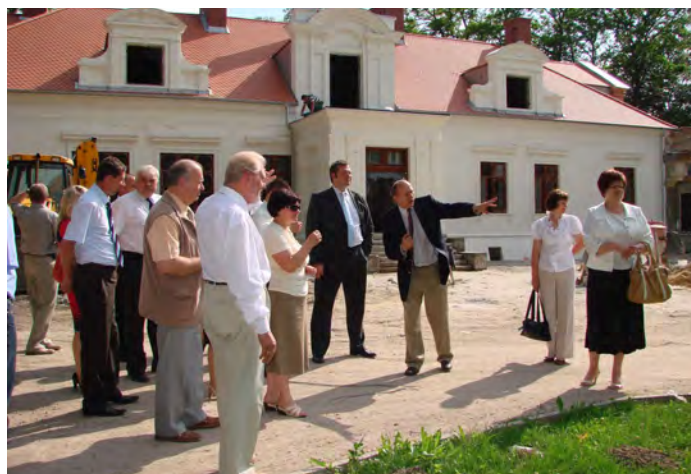
Podczas zwiedzania remontowanego dworu w Sichowie, po którym oprowadzał jego właściciel Stefan Dunin-Wąsowicz.
