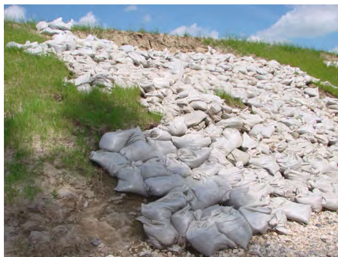
Stan wału wiślanego w Niekurzy wymaga podjęcie reperacji w jak najkrótszym czasie, uszkodzenia sięgają korony wałów, foto z 18.06.2010 r.
