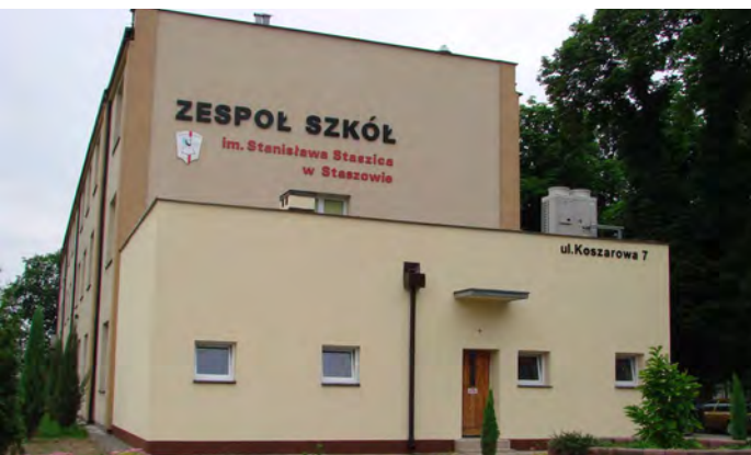
...dobudowano części węzła żywieniowego Internatu Zespołu Szkół, od strony ul. Koszarowej została zakończona, 21 czerwca 2010 r.
