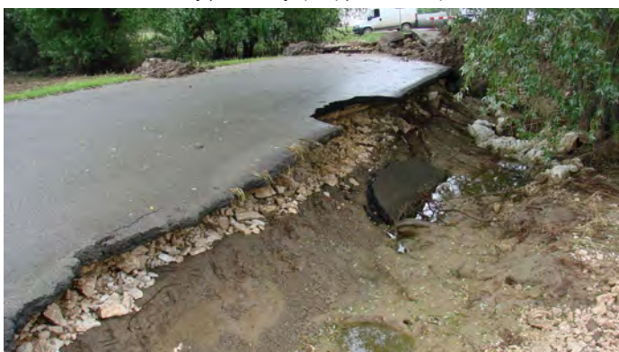
Zniszczona droga powiatowa nr 0820T Połaniec - Budziska.
