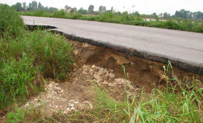
Zniszczona droga powiatowa nr 0820T Połaniec – Budziska, w m. Maśnik.
