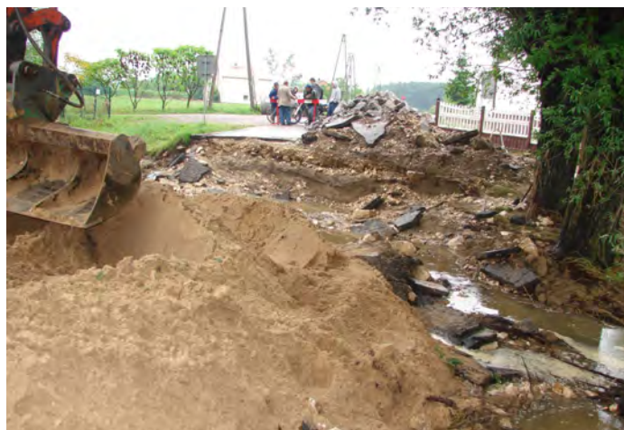
Zniszczona droga powiatowa nr 0820T Połaniec - Budziska, w m. Maśnik.
