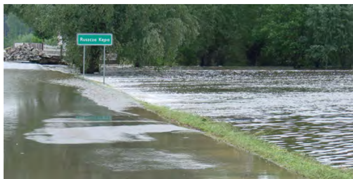
Zalana droga pow. nr 0820T Połaniec - Budziska w m. Ruszcza.
