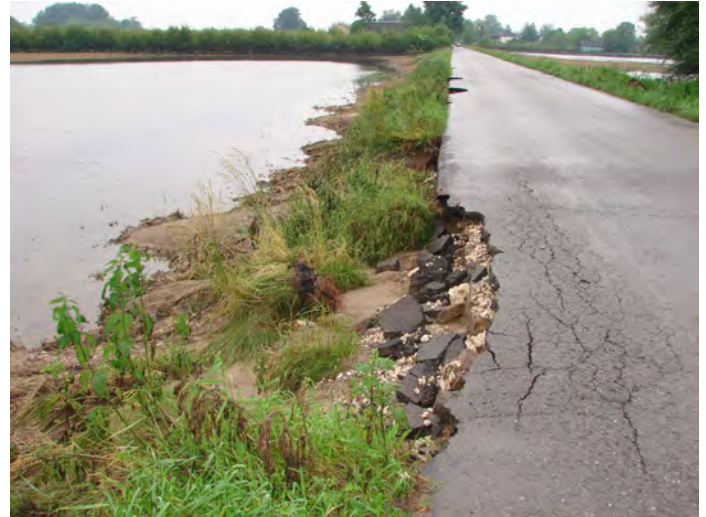
Zniszczona droga powiatowa nr 0820T Połaniec – Budziska, w m. Maśnik.
