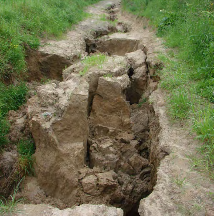
Wyrwy w drodze nr 0844T Szczeglice – Moszyny.
