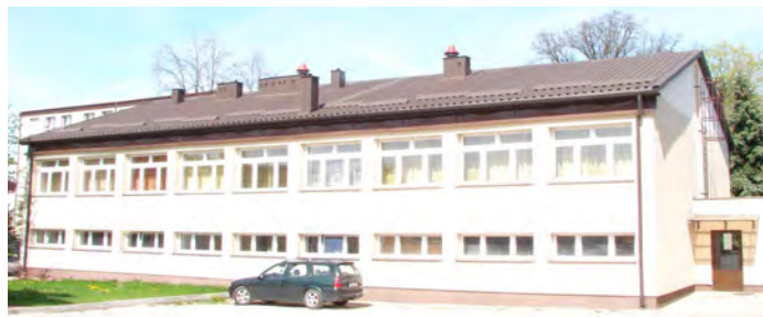
Zakończona nadbudowa dachu nad Centrum Kształcenia Praktycznego przy ul. Koszarowej 7, budynek CKP od strony południowej. 5.05.2010 roku.
