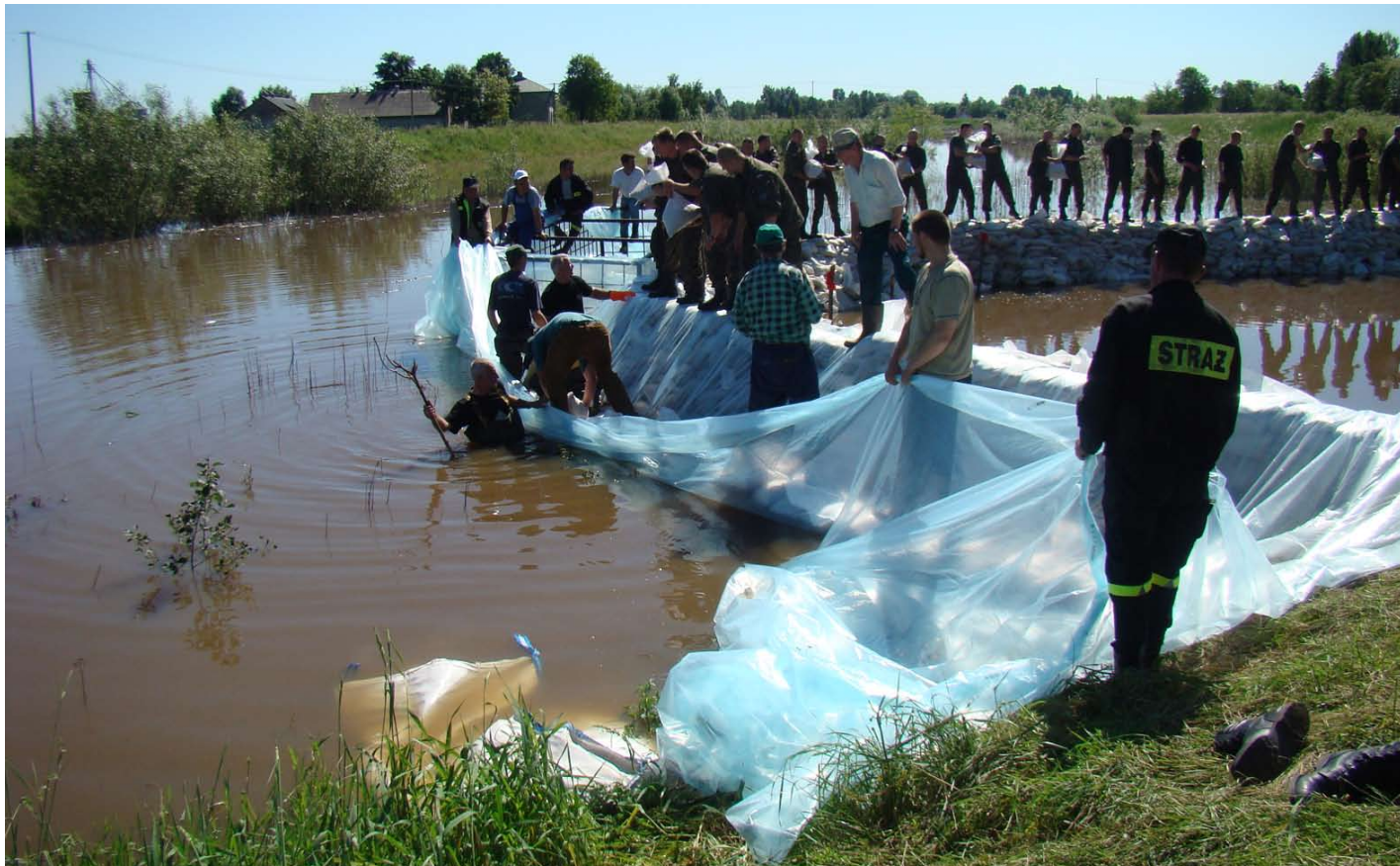
Od soboty rano, 5 czerwca br., trwały intensywne prace wzmacniające wyrwę w wale Kanału Strumień w Rejterówce. Pracami druhów OSP z gminy Łubnice i żołnierzy Batalionu Łączności z Sieradza, koordynował wicestarosta staszowski Andrzej Kruczel, pierwszy z lewej (w wodzie).
