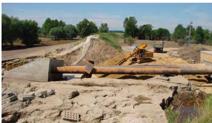
Przepompownia i uszkodzony wał wiślan w Rybitwach. Po zejściu wody, można ocenić stan poczynionych zniszczeń foto z 18.06.2010 r.
