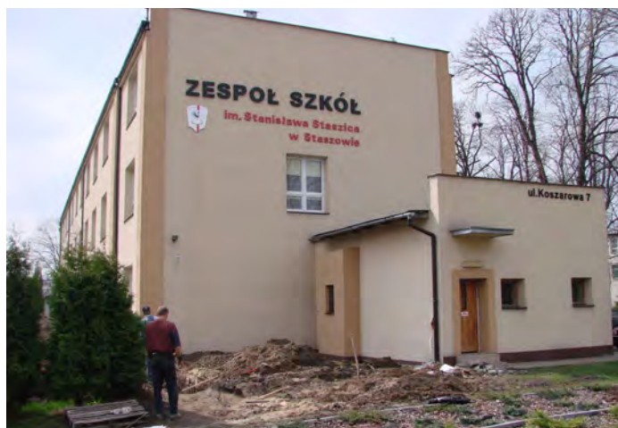
Rozpoczęto dobudowę części węzła żywienia Internatu Zespołu Szkół, od strony ul. Koszarowej. 8 kwietnia 2010 r.
